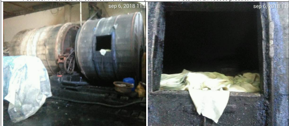
Foto No. 3 Bombos de proceso húmedo
